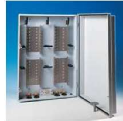
skrzynka kablowa ze stelażami łączówek 10-parowych
